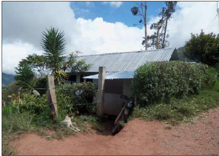
FIGURA 19. VIVIENDA 03 – HUAN 42 – AFECTACIÓN DE VIVIENDA.
