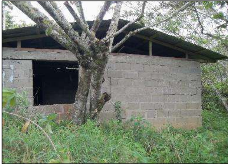
FIGURA 17. VIVIENDA 01 – HUAN 05 – AFECTACIÓN DE VIVIENDA.
